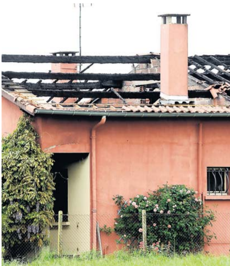
Une maison détruite par la foudre à Plaisance-du-Touch. / DDM, Xavier de Fenoyl
